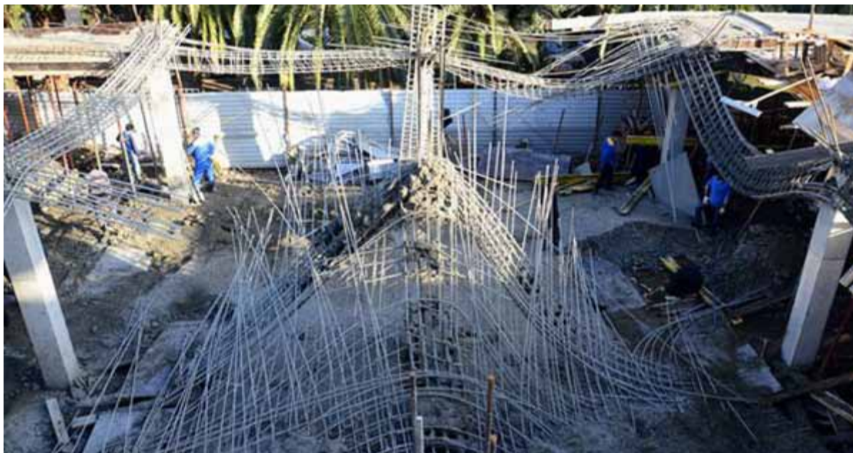
Серьезное обрушение произошло при реконструкции сочинской торговой галереи.
